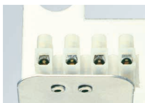
PVC Klemmleiste in Klimaanlage
